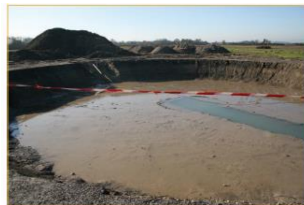
Phénomène de remontée de nappe lors du creusement d'une fondation
