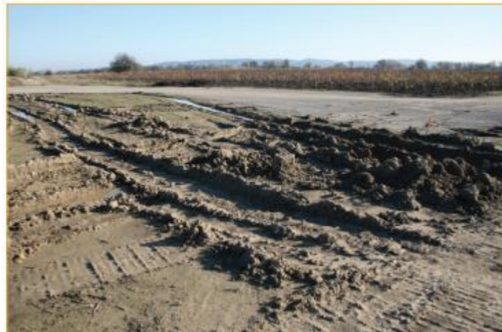
Ornières lors du passage d'un engin de chantier
